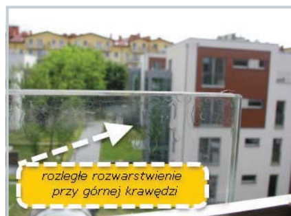
Fot. 7. Górna krawędź (rozwarstwienie)
